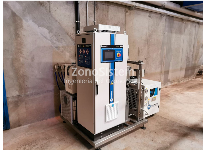
Ozono en Torres de Desodorización de EDAR , España
