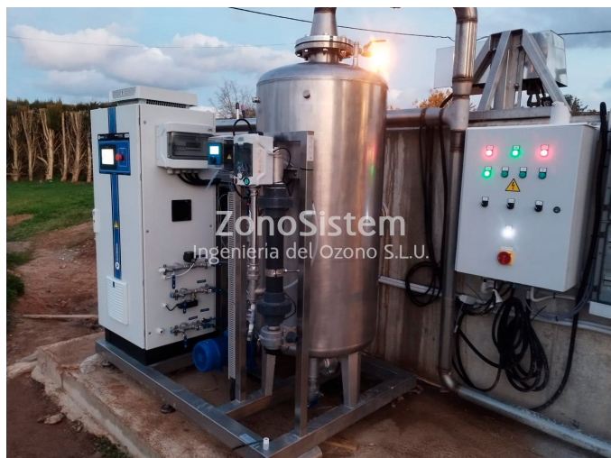
Terciario EDAR en Manacor.
