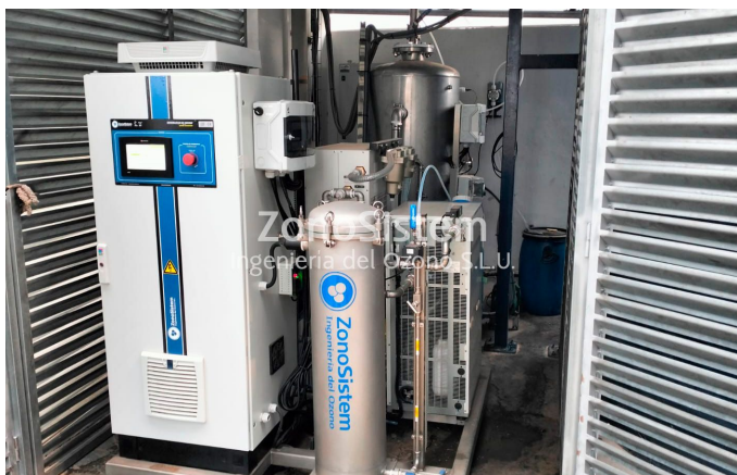
Preoxidación EDAR en Comunidad Valenciana.
