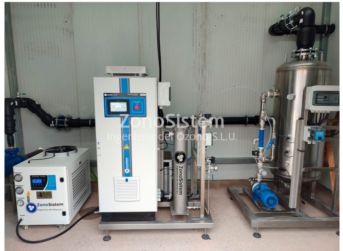
Ozonización de agua de aporte a balsas de riego. Murcia.
