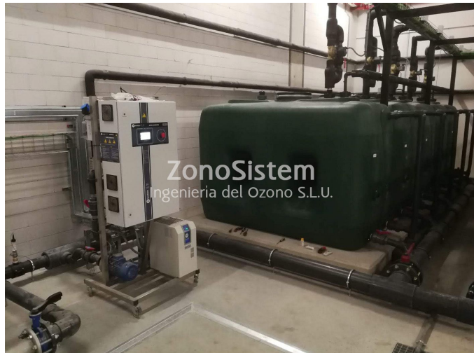
Desinfección de depósitos de agua de riego hidropónico. España.
