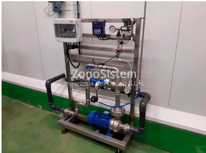
Detalle de planta de recirculación, inyección y medición de Ozono. España.
